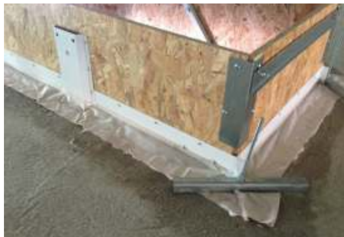
beszerelt állapot: vasbeton szerkezet és padlásfeljáró közti rés hőszigeteléssel kitöltve, vasbeton perem mélyalapozóval lekenve, légzáró fólia födém felső pereméhez ragasztva, padlásfeljáró horganyzott acél zártszelvényeken keresztül a födémkirekesztés sarkainál rögzítve
